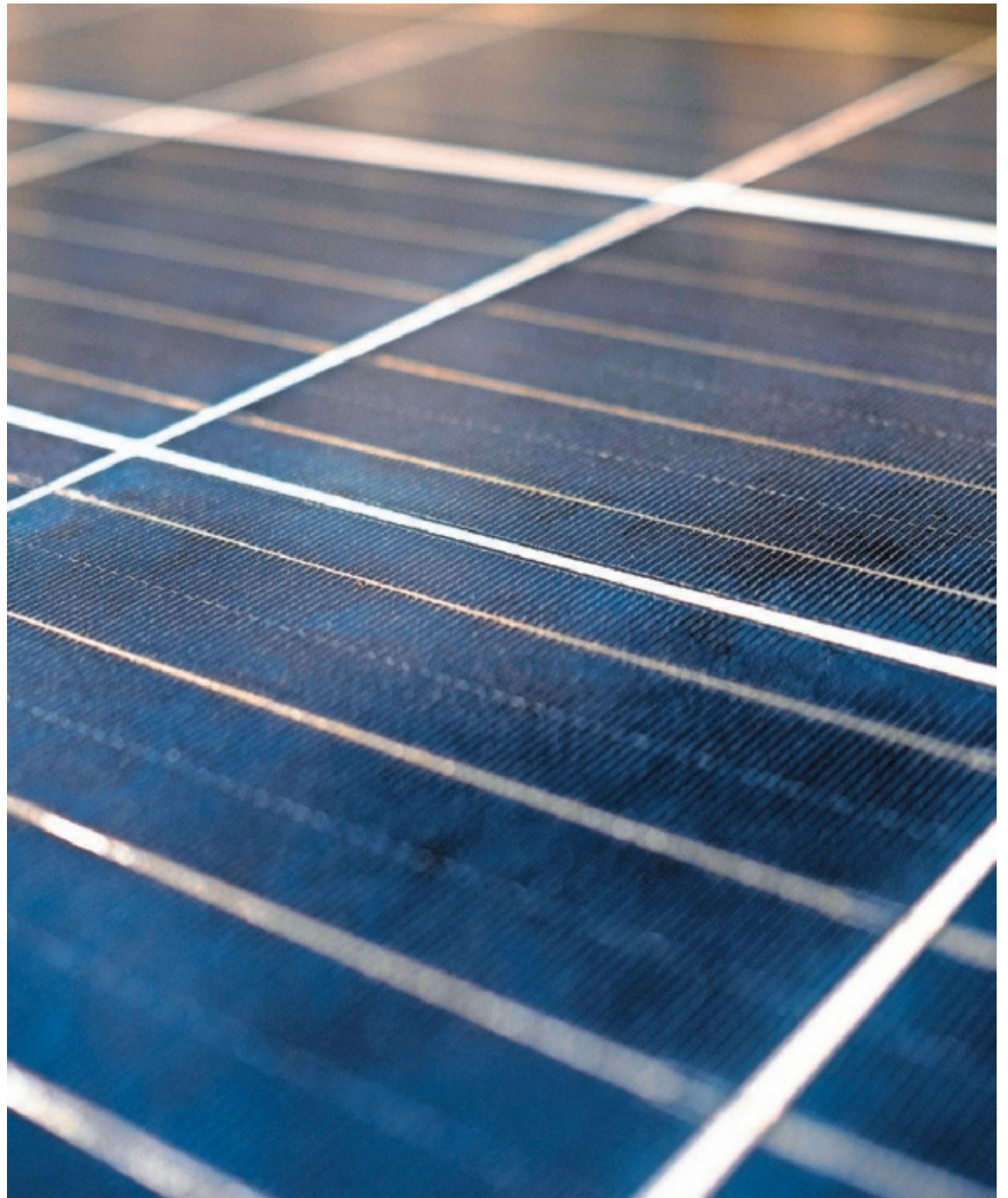
Placas solares en el techo de un edificio industrial.
